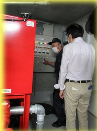
消火ポンプ室の説明
